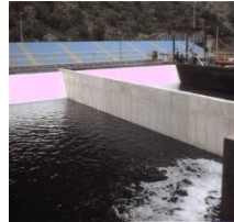
Tratamiento y monitoreo en la descarga de efluentes
